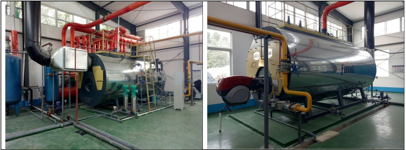
圖、山東美林天然氣鍋爐
